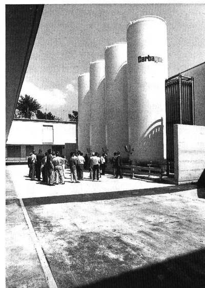
Bild 2. Lagertanks für flüssigen Sauerstoff.
