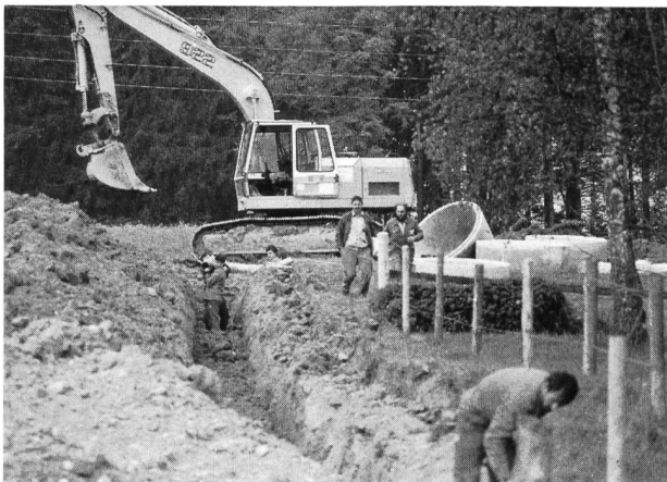
Bild 1. Bagger auf dem «Hübeli» ob Ulmiz. Inzwischen sind die Arbeiten abgeschlossen, und seit Ende Juni fliesst hier bereits gutes Quellwasser aus Jeuss durch die Leitungen. Foto: Ueli Gutknecht
