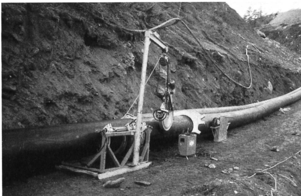
Bild 9. Die dickwandigen Kunststoffrohre der Hangleitungen wurden in einem thermischen Schweissverfahren miteinander verbunden.
