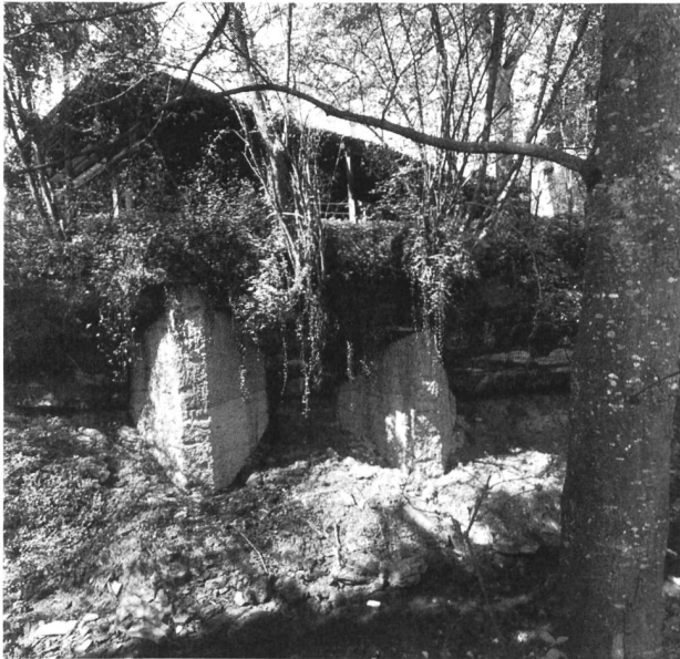
Bild 4. Überhängende Felspartien, mit Betonrippen unterfangen.
