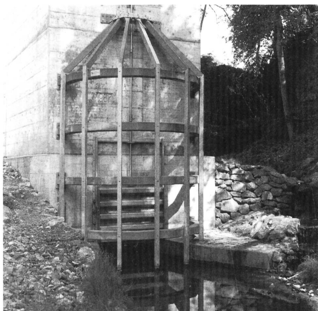
Bild 7. Grobrechen vor Einlauf Drosselöffnung.
