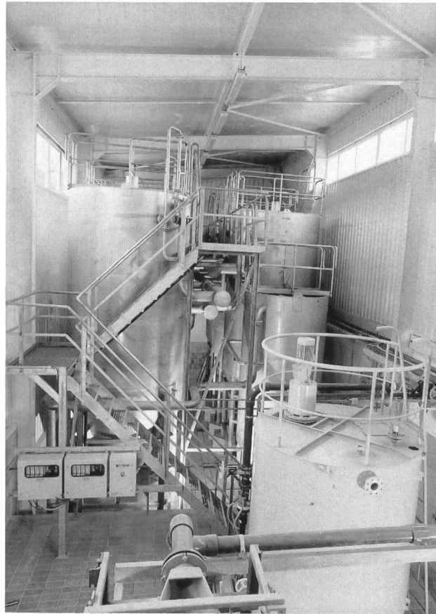
Bild 2. Die Filterhalle des Wasserwerks Ullrichsberg mit DynaSand-Filtern (Axel Johnson Engineering, Neuss).
