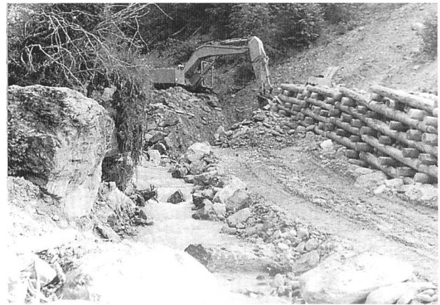
Bild 2. Die massiven Holzkastenwuhren werden mit Bruchsteinen und erdigem Aushubmaterial aufgefüllt und überdeckt. Die schweren Vorbausteine schützen nicht nur die Holzkastenwuhren vor Beschädigungen durch Hochwasser, sie bieten auch Forellen und Kleintieren gute Unterschlupfmöglichkeiten. Diese aus natürlichen Materialien erstellten Verbauungen sorgen künftig für eine Stabilisierung des Rutschhangs im Uferbereich und für einen ungehinderten Durchfluss des Schmuerbach-Wassers.
