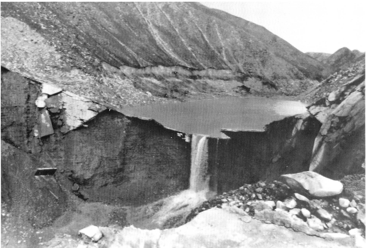
Bild 1. Der Gouhou-Damm in China nach dem Bruch. Blick von der Luftseite auf die Bresche. Teile der wasserseitigen Betondichtung hängen über den ausgewaschenen, kiesigen Stützkörper und bieten dem auslaufenden Wasser noch einen gewissen Widerstand. Die rasche Leerung des Stausees verursachte einige Hangrutsche an den Talflanken (Bild: New China News Agency).
