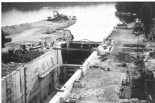
Bild 4. Die fast fertige Schleuse mit den oberen Einfahrhilfen. Das neue Drehsegmenttor ist eingebaut, und der Strömungsrichter aus Stahlbeton im leeren Schleusentrog ist sichtbar.
