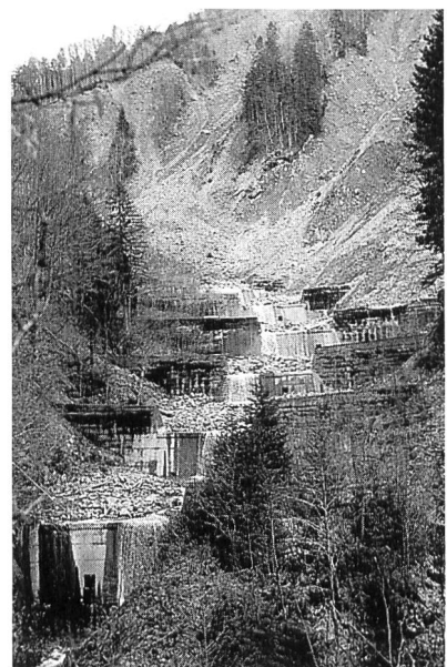
Bild 2. Die Sperren im Abstand von rund 40 m brechen die Wucht des Wassers, verhindern eine Vertiefung des Bachbettes und ein Nachrutschen der Berghänge.
