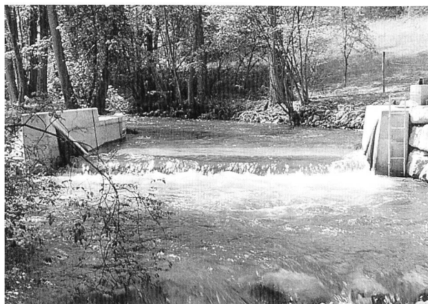
Bild 2. Schlauchwehr in abgesenktem Zustand.
