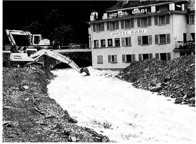
Bild 7. Hochwasser des Chrummbaches bei Gabi VS am 24. September 1994. Dank Sofortmassnahmen wie Ausbaggerung des Bachbettes und Erstellen von provisorischen Schutzdämmen konnten schwerere Schäden vermieden werden. Foto: J. Escher, Gemeindeganzlist, Simplon-Dorf
