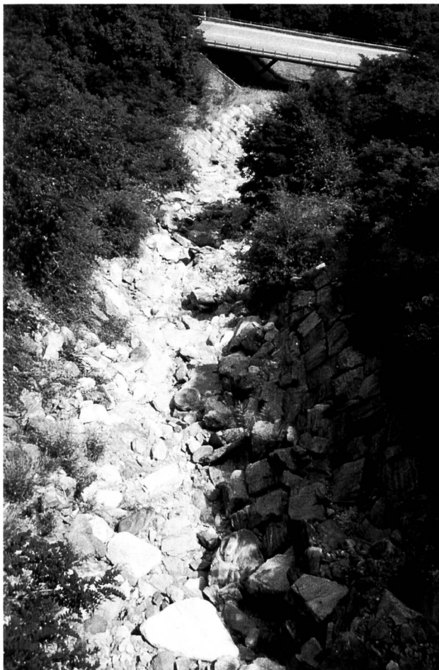
Bild 5. Seitenbach rund 1000 m unterhalb der Wasserfassung bei einem Abfluss, der dem Q_{347} von 20 l/s entspricht. Nichtfischgewässer (Fassung Gaigella der Misoxer Kraftwerke).
