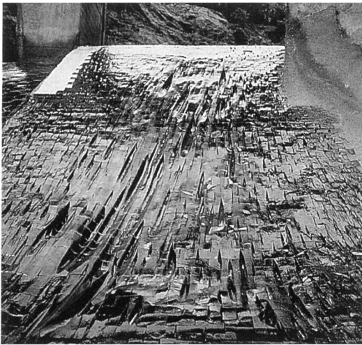
Bild 2. 500000 m 3 Geschiebe pro Jahr hinterlassen ihre Spuren: Die früheren Beton- und Holzauskleidungen mussten jährlich aufwendig saniert werden.
