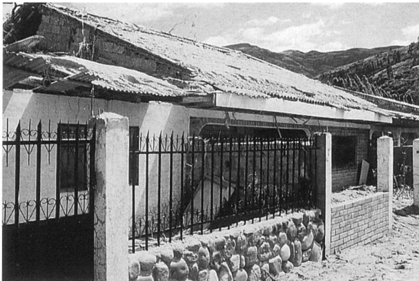
Bild 14. Schäden am Rande des Überschwemmungsgebietes. Teile von Paute zeigten nur Überschwemmungsschäden. Die Höhe der Wasserstände lässt sich am Sand auf den Hausdächern abschätzen.
