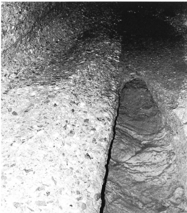
Bild 3. Schaden vor dem Einbau der Teststrecke. Die ursprünglich 40 cm starke Sohle ist vollständig abradert. Darunter hat sich im anstehenden Fels ein tiefer Kolk gebildet.
