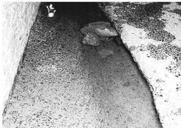
Bild 5. Aus der ungenügend verdichteten Randzone des Walzbetonfelds wurde eine 30 cm tiefe Rinne abradiert. Der genügt verdichtete Mittelteil des Feldes (rechts im Bild) weist keine nennenswerten Schäden auf.
