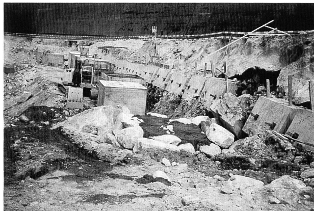
Bild 21. Erstellung der Betonprismen im Schutze einer verankerten Elementwand; im Vordergrund mit Residualblock verkabelte Blöcke (Gurtellen-Güetli).
