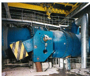
Aménagement Cleuson-Dixence Le Chargeur: vue sur la vanne papillon de sécurité. Wasserkraftanlage Cleuson- Dixence. Le Chargeur: Drosselklappe (Foto H. Preisig, CH-1950 Sion le 4 mai 1998).
