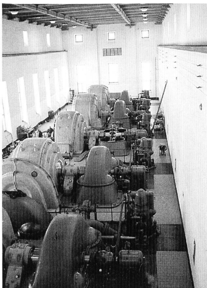
Bild 2. Maschinensaal der Zentrale Küblis.
