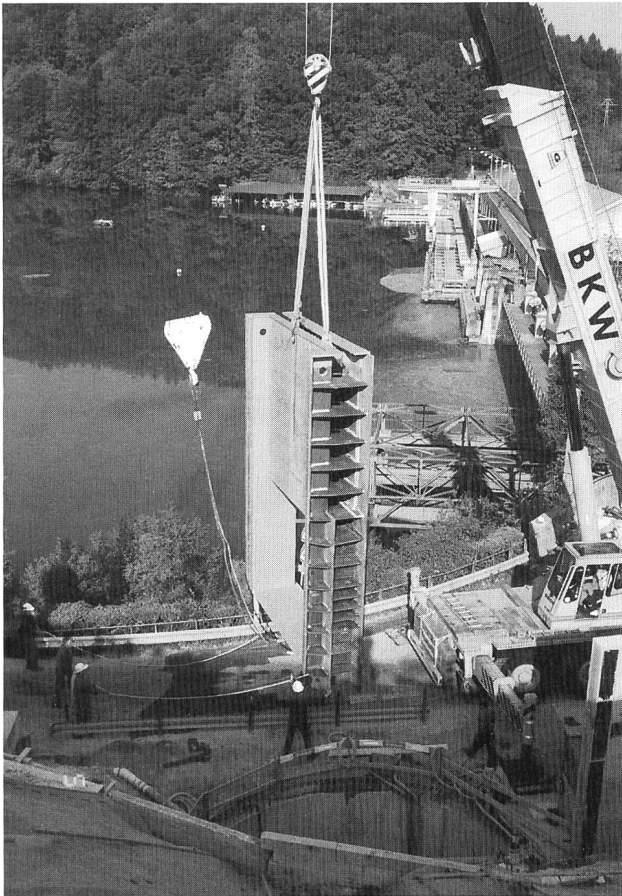
Bild 4. Ein Schützengehäuse bereit zum Absenken. Im Vordergrund ist der Schützenschacht zu erkennen. Hinter dem BKW-Kran sind das Wehr und das Maschinenhaus zu sehen.
