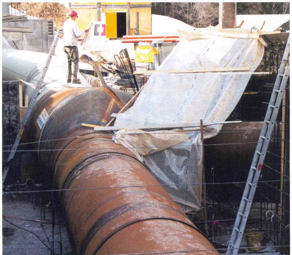
Bild 6. Anschlussbereich bei Zentrale. Im Vordergrund neuer Teil Verteilung mit Schalungen für Fixpunkt. Im Hintergrund Übergang Rohrkeller in den Rohrstillen.
