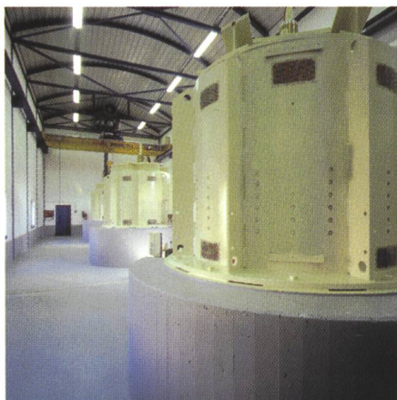
Bild 2. Das geräumige Maschinenhaus beherbergt in der Schweiz erstmalig eingesetzte Technik. (Foto: Ferit Kuyaz)
