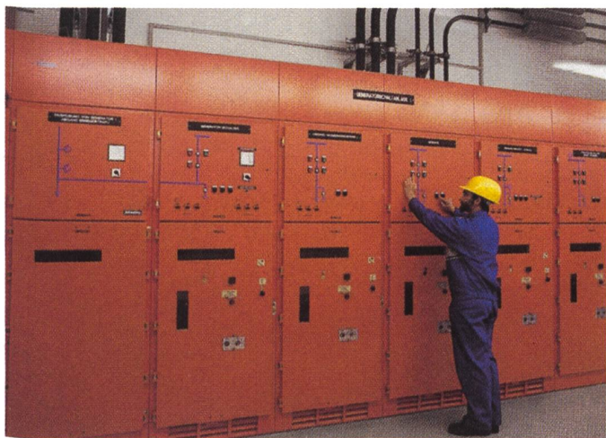
Bild 16. Kraftwerk Wildegg-Brugg: Neue, gekapselte 8-kV-Generator-Schaltanlage.
