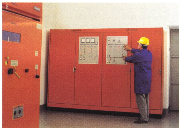
Bild 17. Kraftwerk Wildegg-Brugg: Nebensteuerstelle der Eigenbedarfs-Schaltanlage.
