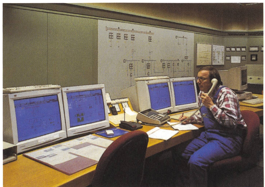
Bild 21. Kraftwerk Wildegg-Brugg: Neues Bediensystem im bestehenden Kommandoraum.
