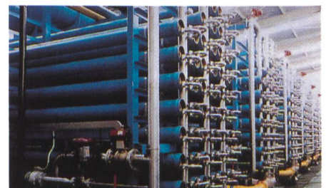
Bild 1. Palma de Mallorca: Entsalzungsanlage nach dem Verfahren der Umkehrosiose mit einer Kapazität von 39 000 m 3 /Tag (Quelle: Degremont).
