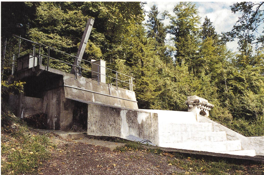
Bild 8. Kraftwerkseinlauf mit neuer Rechenreinigungsmaschine und seitlichem Überfall zur Wasserentlastung bei zu hohem Kanalpegel.
