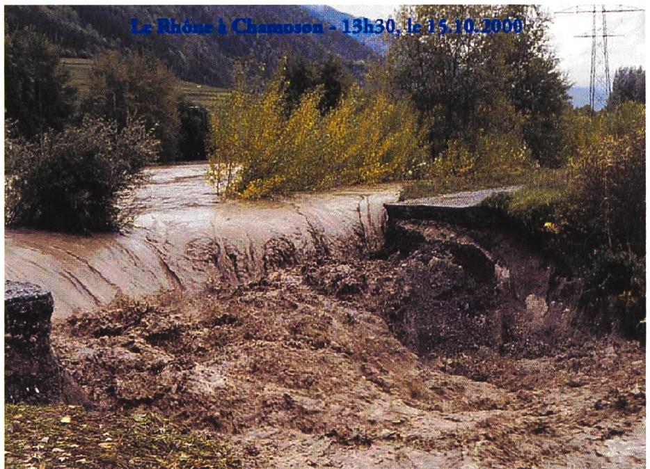
Figure 1. Rupture de la digue du Rhône à Chamoson le 15 octobre 2000.
