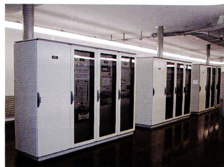
Bild 6. Leittechnik und Vorortsteuerung für Maschinen Nr. 1-3.
