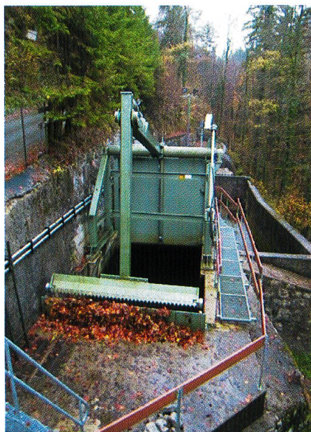
Bild 2. Neue Rechenreinigungsmaschine im Wasserschloss.
