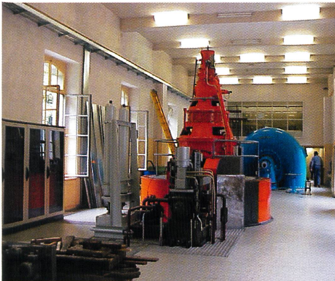
Bild 3. Revidierte Turbinen-Generatorgruppe Nr. 2, im Vordergrund der umgebaute Turbinenregler, links die neuen Maschinenleittechnik-Schränke.
