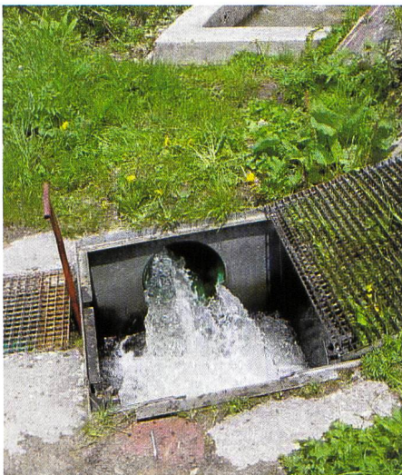
Bild 1. Der alte Einlaufschacht mit vertikalem Gitterrost.
