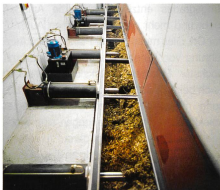
Bild 1. Transport der Holzschnitzel in die Feuerung.
