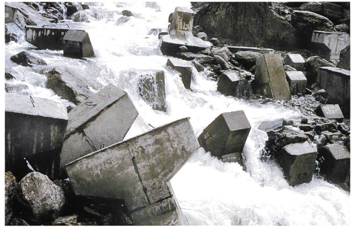
Bild 4. Blockrampe aus CABs im Charnawati River. Die Elemente sind durch die Strömung zusammengeschoben worden und haben sich untereinander verhakt. Zwischen den CABs abgelagertes Geschiebe verfestigt die Struktur zusätzlich.
