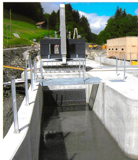
Bild 2. Entsander-Einlauf mit Feinrechen und Rechenreinigungsmaschine.
