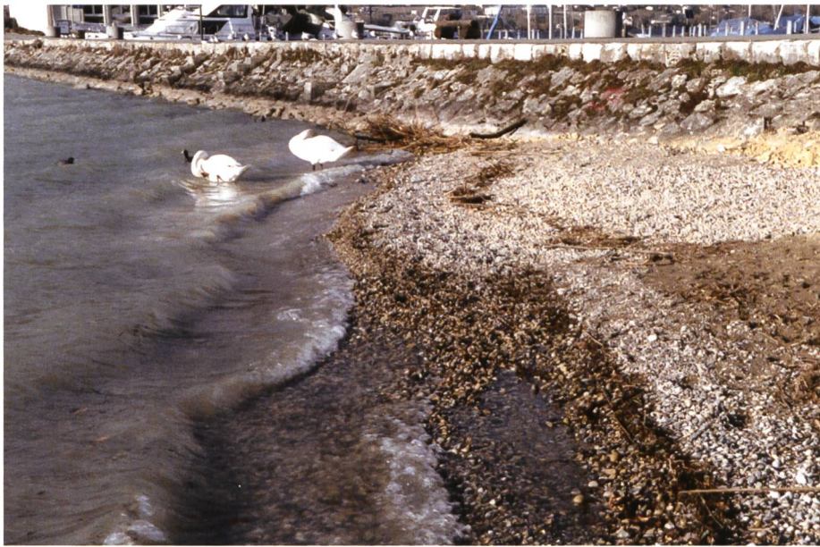
Bild 6. Eine Mole bildet den seitlichen Abschluss der Kiesschüttung. Die Wellen werden der Mole entlang jedoch beschleunigt und treffen mit erhöhter Energie auf den Kieskörper auf. Bereits kurz nach dem Einbau ist hier eine Materialverlagerung entlang des Dammfusses festzustellen. Dies führte in der Folge zu einer übersteilen Böschungsneigung, weshalb die Stelle nachträglich mit einer Pflasterung aus Blöcken gesichert werden musste.
