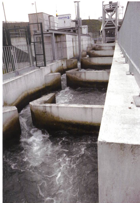
Bild 1. Oberster Abschnitt der Fischtreppe.
