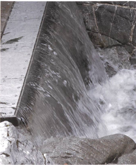
Bild 3b. Geophonsystem im Einsatz im Vogelbach (Alptal, Kt. Schwyz; Foto B. Reye, Tages-Anzeiger); die Stahlkonstruktion ist an der Unterwasserseite einer Wildbachsperre montiert. Die Stahlplatten haben Abmessungen von 36x50 cm.
