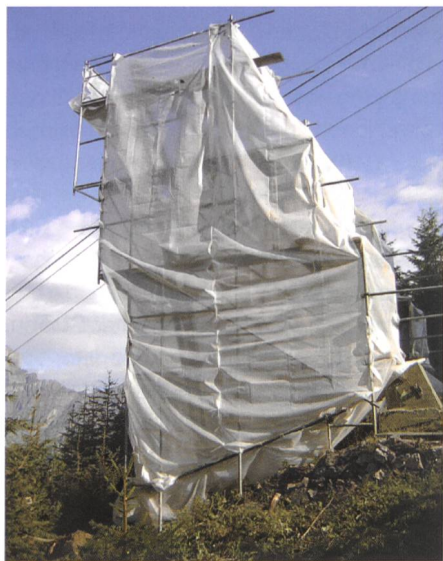
Bild 3. Einhausung von Seilbahnmasten.
