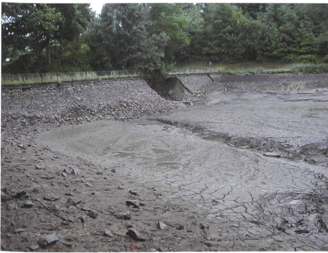
Figure 3. Barrage des Ouches ( H = 7\text{ m} , 49\,000\text{ m}^3 ), victime d'une rupture par érosion interne, deux siècles après sa construction. Il n'y a pas eu de victimes dans le village situé 4 km en aval grâce à ses petites dimensions mais aussi grâce à la présence d'esprit de l'exploitant qui a rapidement prévenu la gendarmerie qui a demandé aux personnes présentes dans les rues un dimanche matin de se mettre à l'abri.
