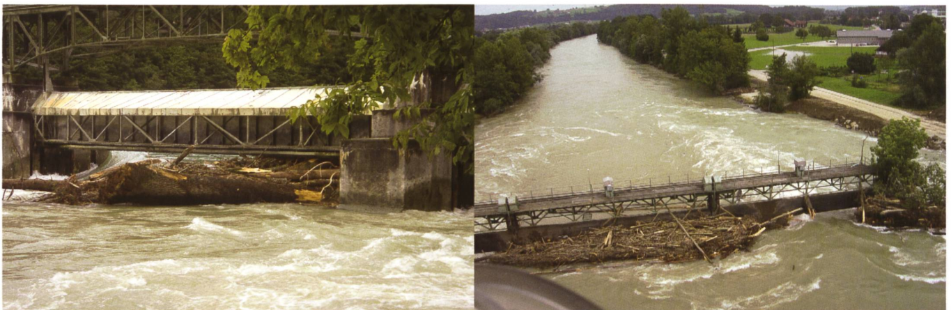
Bild 3. Beim Hochwasser 2005 aufgetretene Verklausung der Reuss-Wehre Rathausen (links) und Perlen (rechts).
