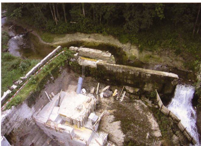
Bild 5. Bestehende Hochwasserentlastung (Streichwehr) während der Bauausführung. Man beachte die erodierte Zone an der Engstelle am linken Widerlager.
