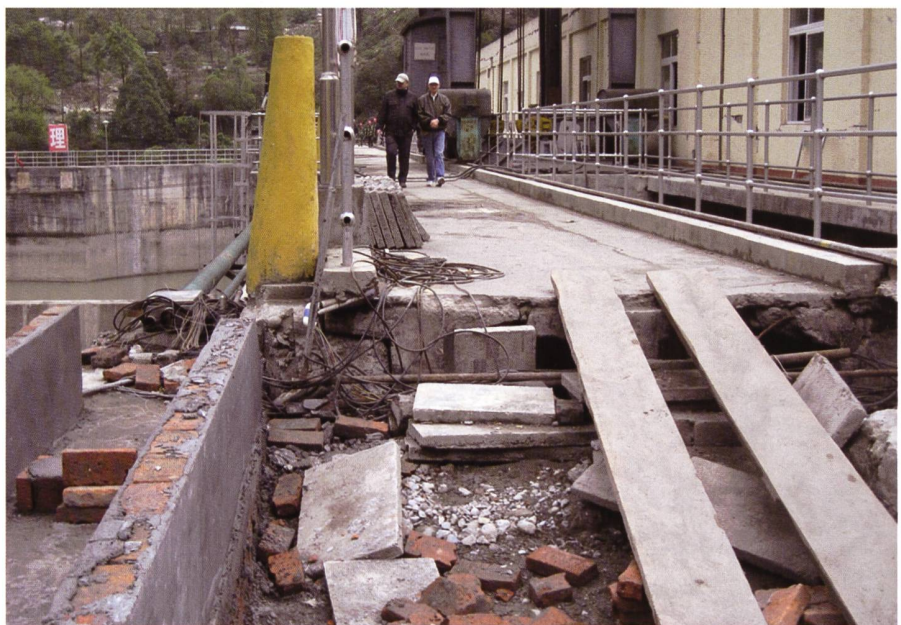
Bild 9. Differenzielle Setzung zwischen Betondamm (hinten) und seitlichem Erddamm (vorn) wird mit Brettern überbrückt.
