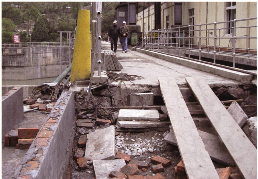
Bild 9. Differenzielle Setzung zwischen Betondamm (hinten) und seitlichem Erddamm (vorn) wird mit Brettern überbrückt.
