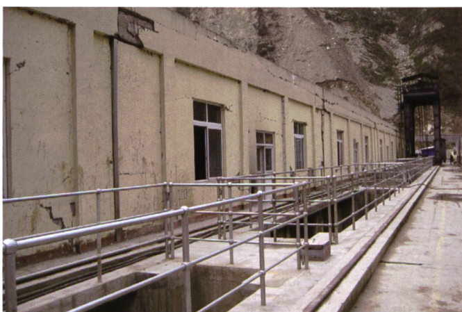
Bild 7. Wehranlage Yingxiuwan: Schäden am Wehrbauwerk.
