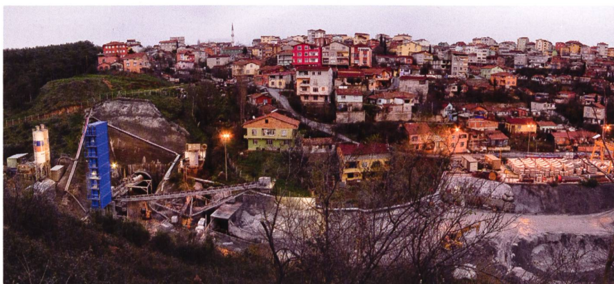
Bild 3. Startschacht (links) und Tübbingfertigung (rechts) im Stadtteil Sariyer im europäischen Teil Istanbul.
