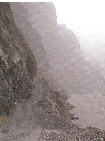
Bild 11. Einzige, ganzjährig offene Strassenverbindung zwischen West- und Ost-Tadschikistan 2003, vor dem Ausbau. Fluss: Pyandj.
