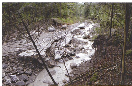
Bild 5. Dürrenbach. Zerstörte Bachschale. Blick in Fließrichtung. (Foto Bänziger Partner AG).
