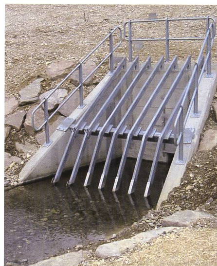
Bild 7. Einlaufbauwerk mit Drosselöffnung und Grobrechen.
