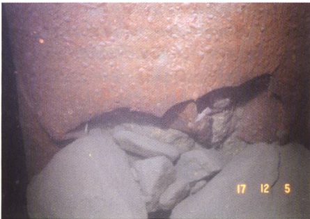
Bild 12. Die Panzerung der Trennwand zwischen den Parallelschützen des Grundablasses ist von den ausgeführten Spülungen stark beschädigt.
