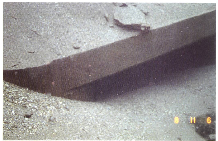
Bild 4. Die Inspektion mit einer Unterwasserkamera hat gezeigt, dass vom drei Meter hohen Einlaufwerk nur noch die obersten 30 Zentimeter sichtbar sind.
