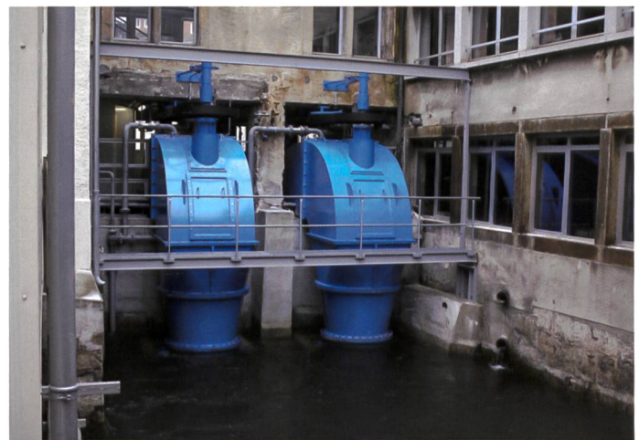
Bild 9. Heberturbinen des MHyLab-Konzepts in Vallorbe.
