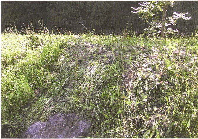
Bild 2. Hochwasserschutzdamm der Lütschine unterhalb von Wilderswil nach dem Hochwasser von August 2005. Der Damm wurde leicht überströmt, der Grasbewuchs hat die Böschung (noch) vor Erosion geschützt.
