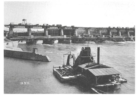
Bau Stauwehr/April 1912: Im Gegensatz zu den beiden Maschinenhäusern wurde das 212 Meter lange Stauwehr gemeinsam errichtet. (Quelle: Energiedienst)
