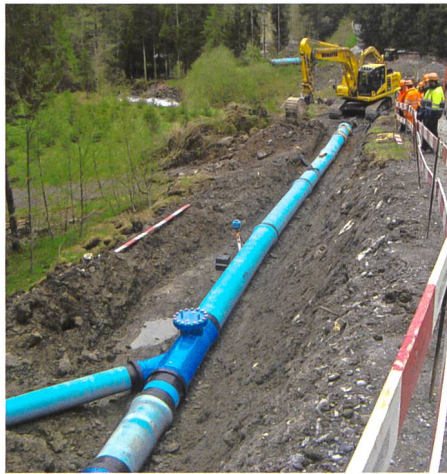
Bild 19. Druckleitung DN600 mit Vereinigung und Inspektionsöffnung (April 2015).
