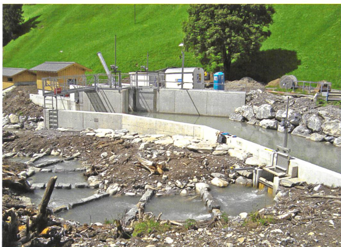
Bild 5. Blick auf den Fischpass (Beckenpass Raugerinne) der Fassung Fermelbach (Aug. 2016).
