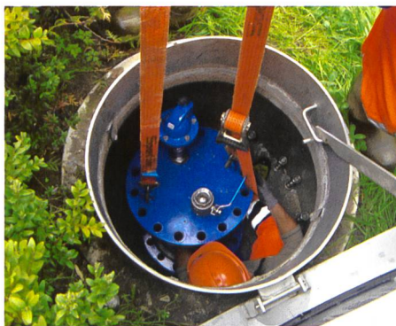
Bild 21. Inspektionsöffnung mit Entlüftungsventil Hochpunkt Düker (Mai 2016).
