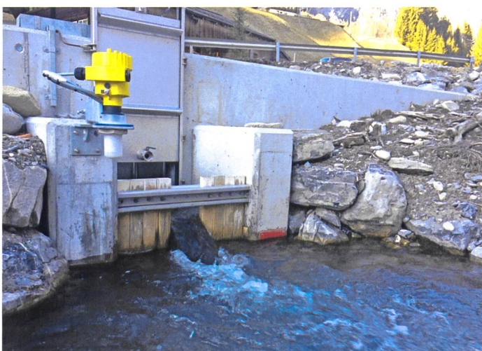
Bild 6. Blick (gegen die Fließrichtung) auf das Einlaufbauwerk des Umgehungsgerinnes mit Restwasserabgabe. Die Pegelmessung ist oben links ersichtlich, die rote Markierung in der Mitte des Bildes stellt die optische Überprüfung der Restwassermenge dar (März 2017).
