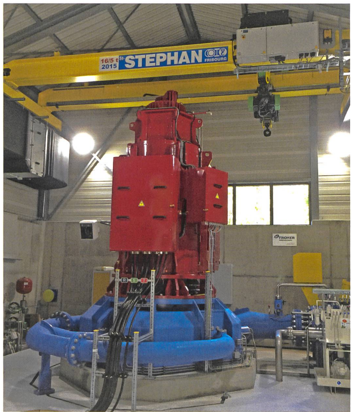
Bild 10. Blick auf die Pelton turbine in der Zentrale Matten.
