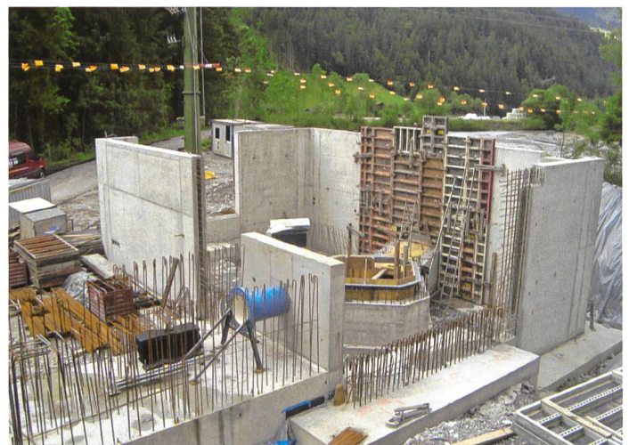
Bild 15. Blick auf die Zentrale Matten, links zukünftiger Fixpunkt (Bewehrung) und in der Mitte Turbinenstandort (Juni 2015).
