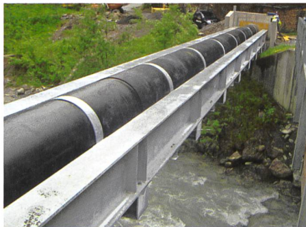
Bild 20. Rohrbrücke mit isolierter Druckleitung DN 600 (Mai 2015).
