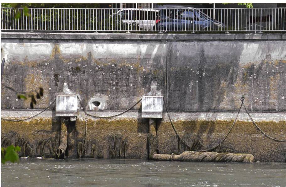
Bild 3. Freigelegte Kühlwasserentnahme oberhalb des Platzspitzwehrs, Fliessrichtung von rechts nach links. Rechts die Fassung mit dem Seiher, links die Rückgabe (Quelle AWEL).
