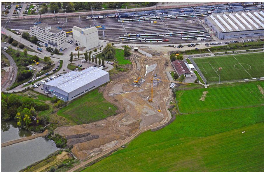
Bild 6. Vorbelastung im Bereich Durchlass während der Bauarbeiten im nachfolgenden Tosbecken, Blick Richtung Westen.
